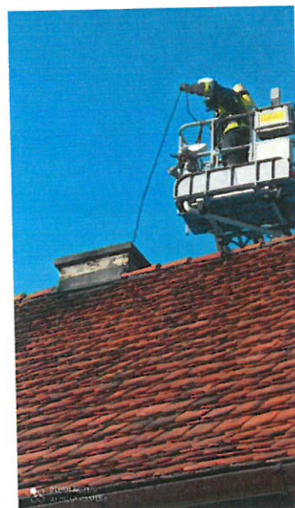
Pożar sadzy w przewodzie kominowym
