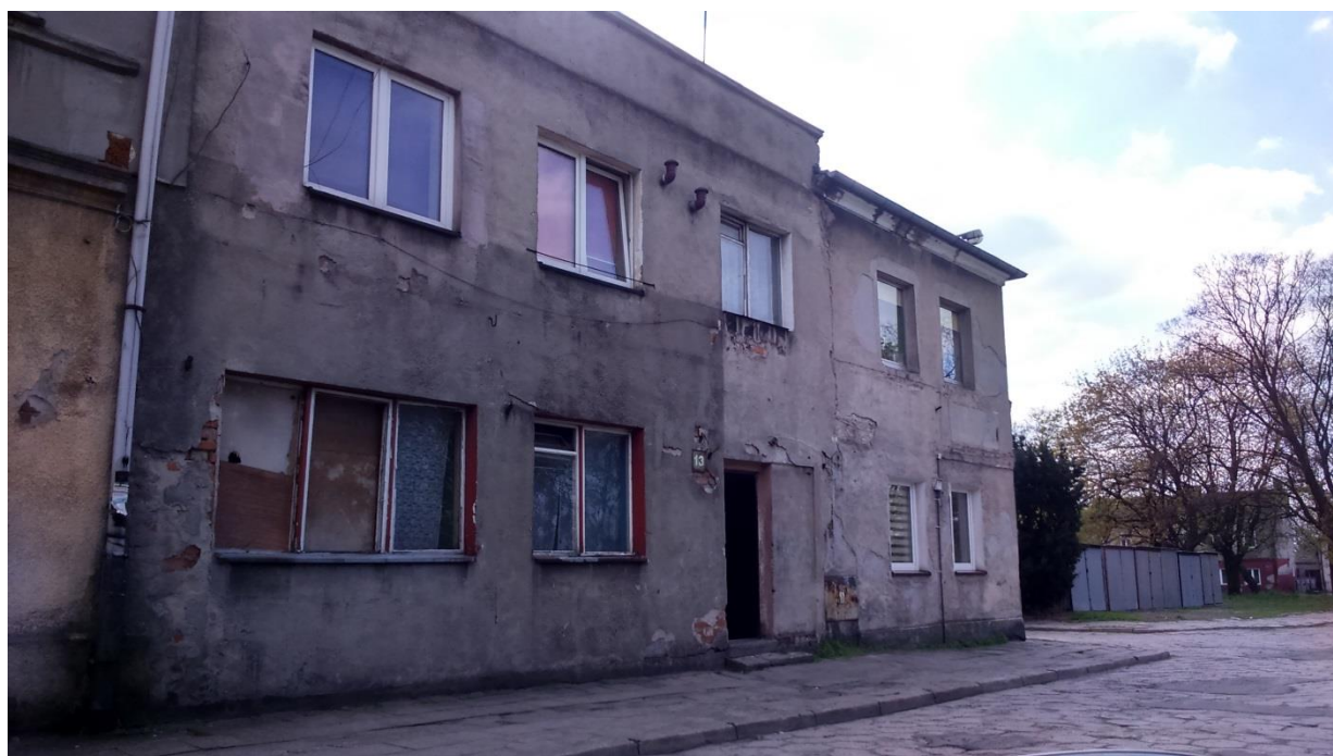
Rysunek 11 Zniszczony budynek przy ul. Wschodniej (źródło: Remedis SA)
